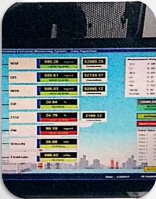
Sistem DAS (PT Krakatau Daya Listrik)
